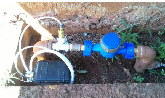
Figura 5 - Logger 450428 instalado no hidrômetro da UTFPR.
