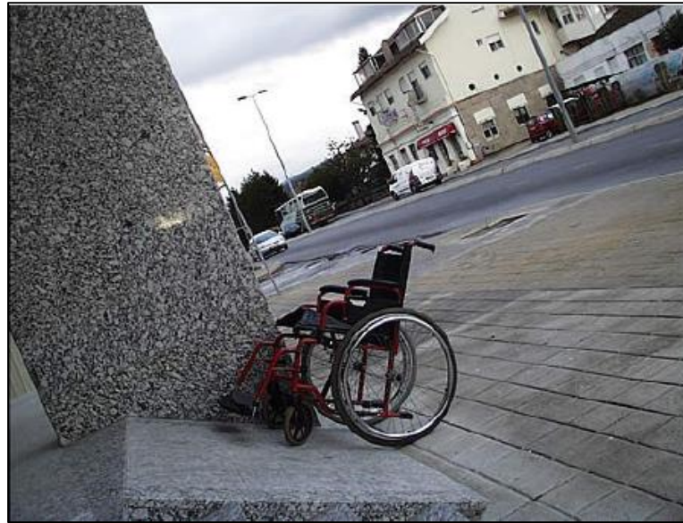
Figura 35 – Rampa projetada fora das normas da NBR 9050 Fonte: Ana Carolina Cardoso (2014).
