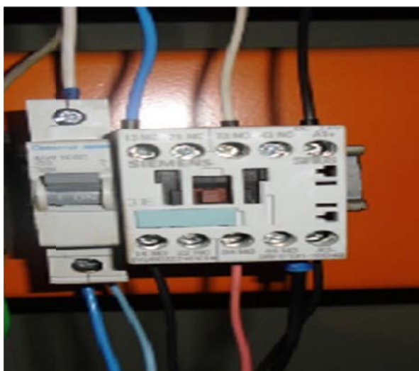
Figura 6 - Disjuntor de proteção e contator auxiliar 12 Vcc.
