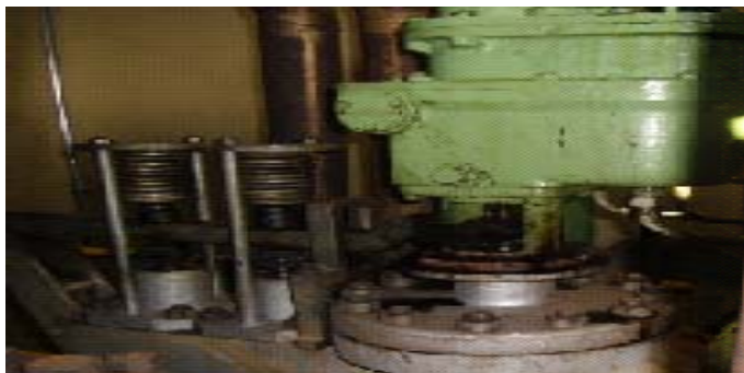
Figura 1 – Multi válvulas (controlam a entrada de vapor nos estágios da turbina).
