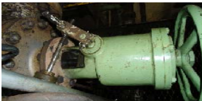
Figura 2 - Válvula de entrada de vapor.
