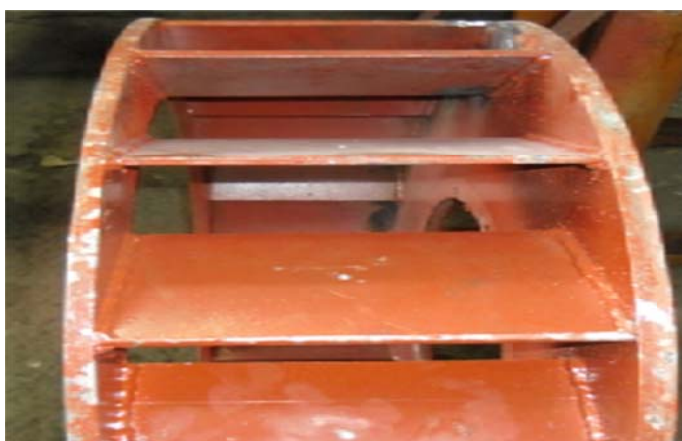
Figura 3 – Ventilador de resfriamento interno antes do disparo.
