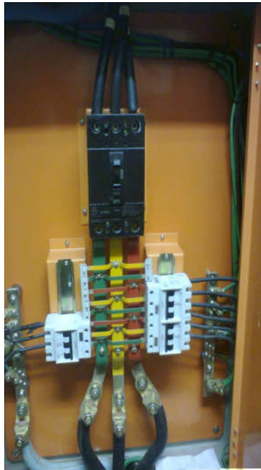
Fotografia 2 - Imagem do disjuntor 225A
