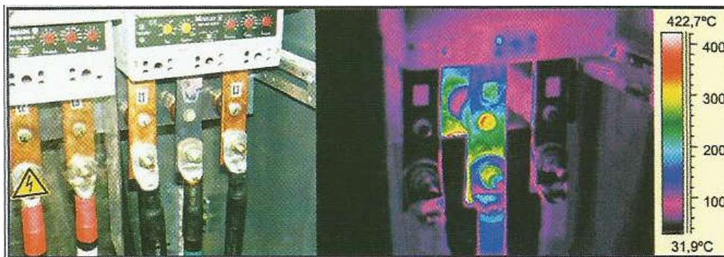
Figura 6 – Falha no terminal de um disjuntor.
