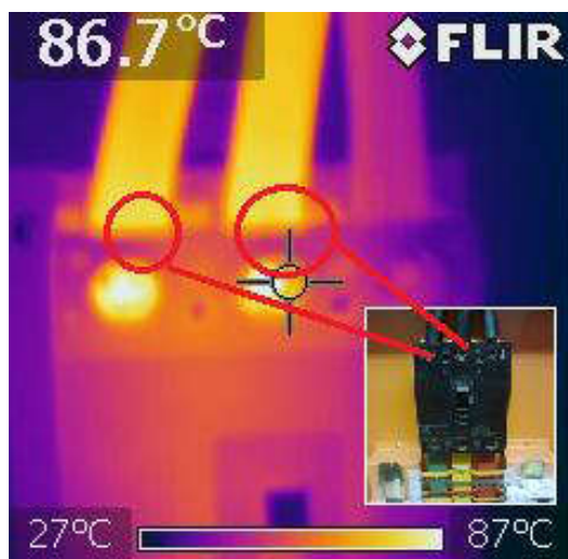
Figura 13 - Imagem termográfica disjuntor 225A
