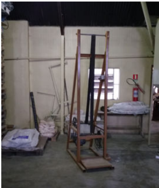
Figura 15 - Obstrução de espaço próximo ao extintor Fonte: A autora (2016).
