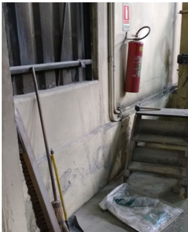
Figura 16 - Obstrução de espaço próximo ao extintor Fonte: A autora (2016).
