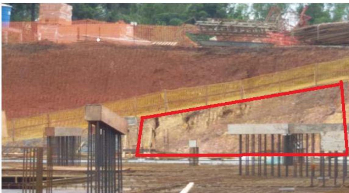
Figura 19 – Exibição de dois Horizontes em um mesmo talude exposto Fonte: Autoria própria (2014)
