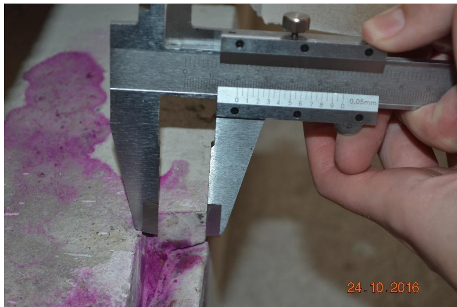
Figura 26 – Profundidade de carbonatação antes da aplicação do método (20mm) Fonte: Acervo dos autores (2016).
