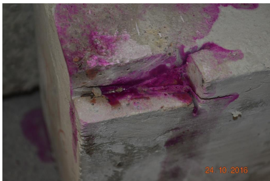
Figura 25 – Corte inicial antes da aplicação do método – viga carbonatada Fonte: Acervo dos autores (2016).
