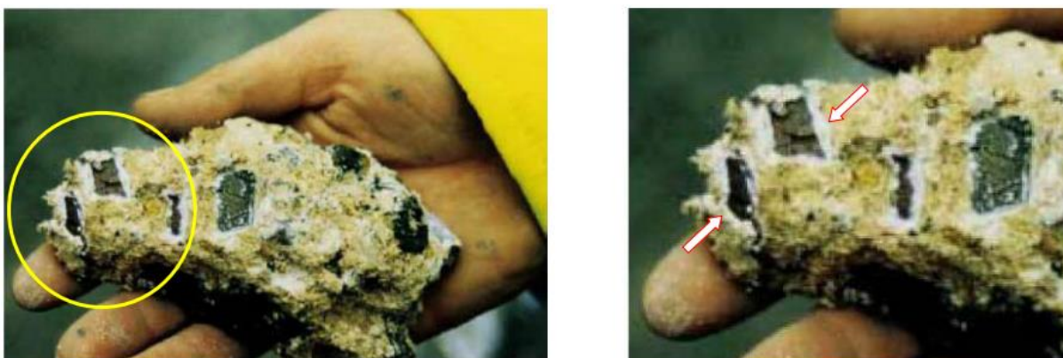
Figura 9: Pedaco de concreto de fundação de ponte deteriorado por íons sulfato Fonte: Thomaz (2016)
