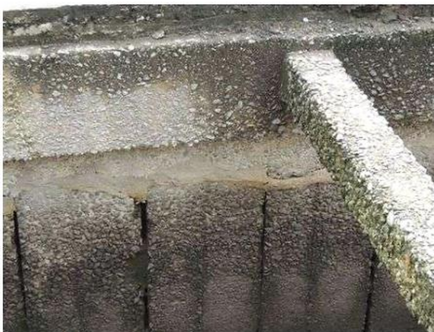
Figura 13: Canal atacado por íons sulfatos provenientes da água Fonte: Thomaz (2016)
