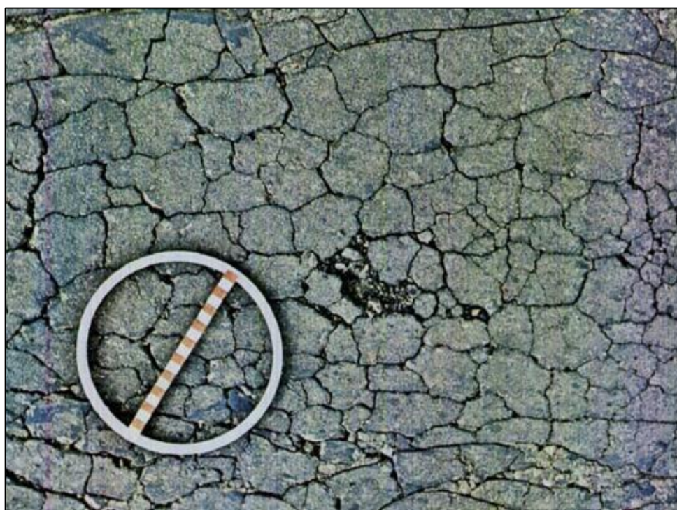
Figura 4 - Trinca Interligada Tipo Jacaré Fonte: DNIT 005/2003
