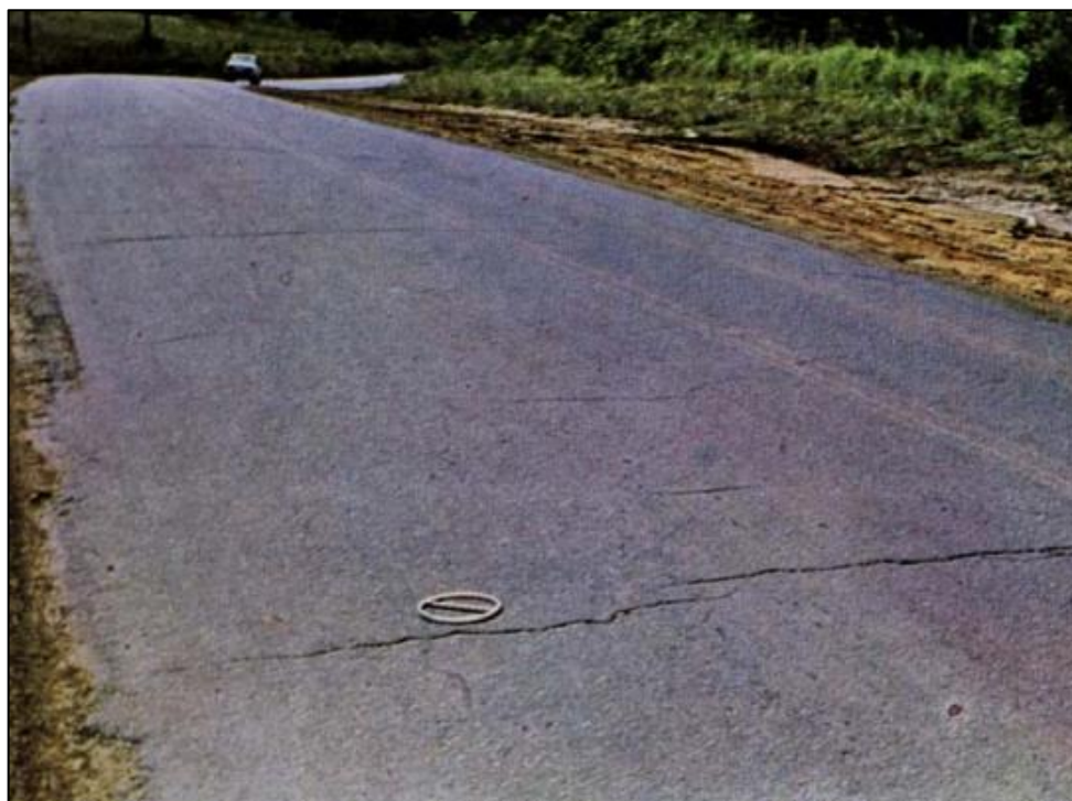
Figura 5 - Trinca Isolada Transversal Fonte: DNIT 005/2003
