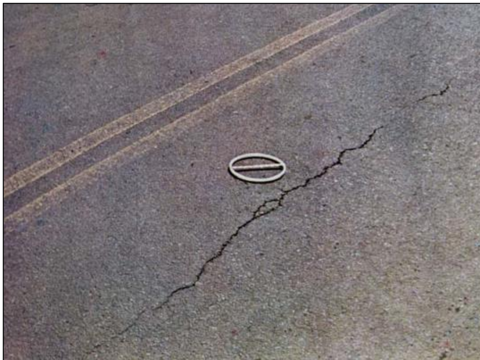
Figura 3 - Trinca Isolada Longitudinal Fonte: DNIT 005/2003
