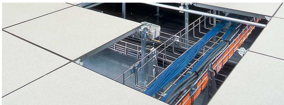
Figura 12 - Sistema de piso elevado e bandejas de cabeamento Fonte: Caviglia (2015)
