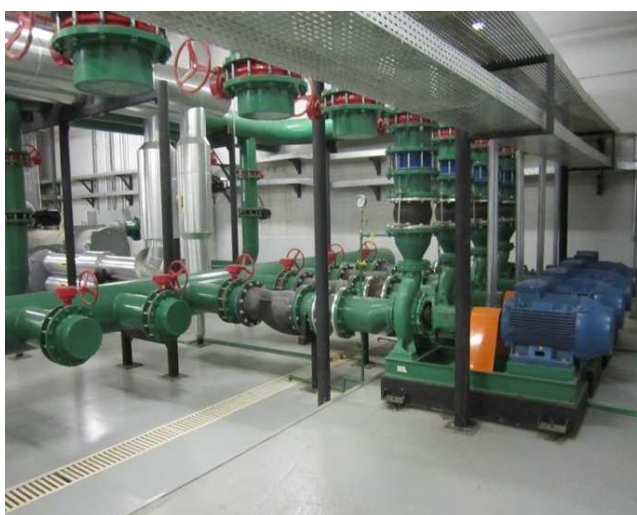
Figura 08 - Bombas do sistema de refrigeração Fonte: Arquivo do autor (2015)
