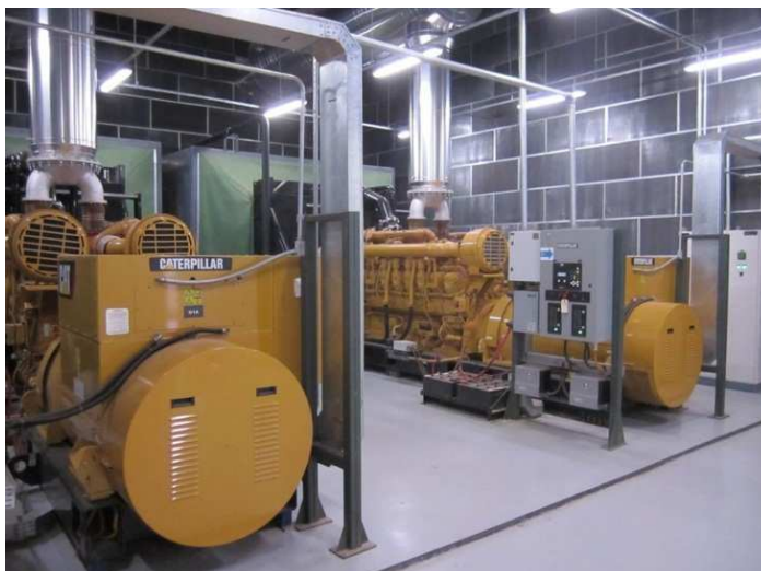
Figura 15 - Grupos geradores Fonte: Arquivo do autor (2015)
