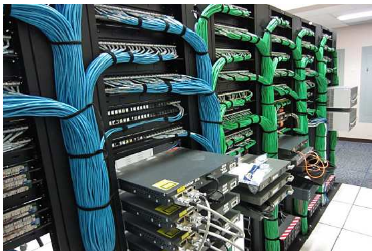
Figura 13 - TR utilizando piso elevado Fonte: Cable Concept (2015)
