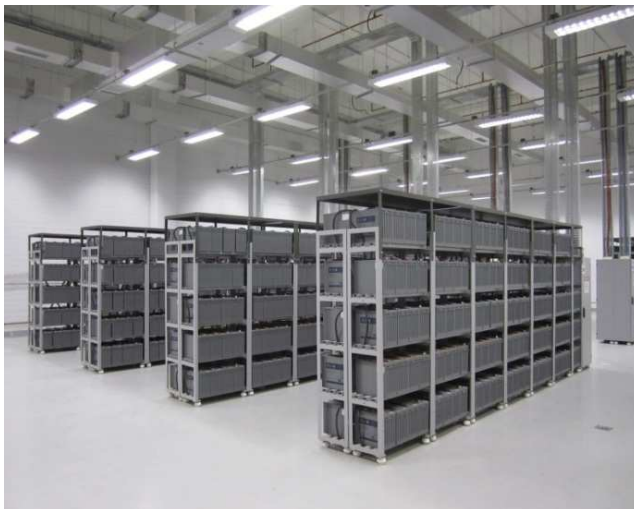
Figura 07 - Banco de baterias do UPS Fonte: Arquivo do autor (2015)
