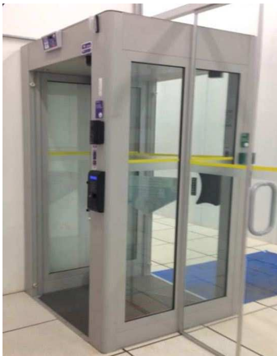
Figura 11 - Sistema de controle de acesso por biometria Fonte: Arquivo do autor (2015)
