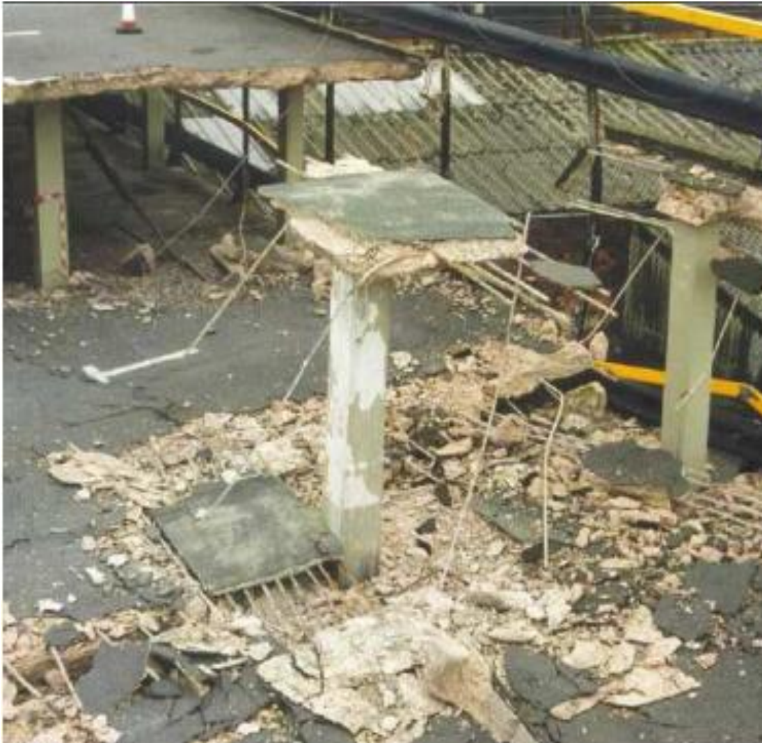
Figura 2 – Colapso por esforços de punção
