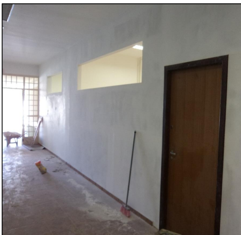
Figura 18 - Resíduo proveniente de lixamento de parede após emassamento. Fonte: Autoria própria.
