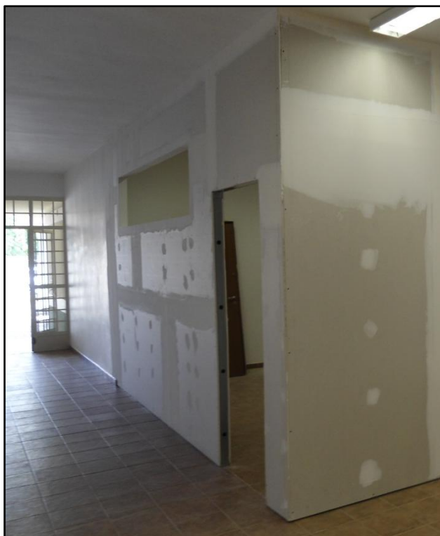
Figura 16 - Vãos nas divisórias em drywall . Fonte: Autoria própria.
