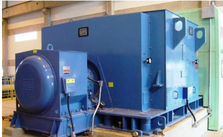
Figura 21- Gerador assíncrono Fonte: CERPCH (2015.).
