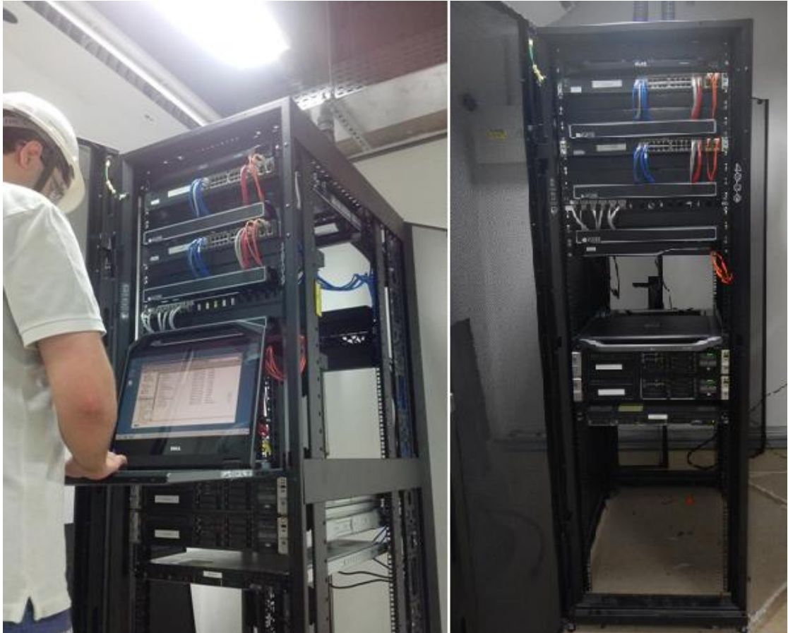
Figura 12 - Rack de TI da eclusa Fonte: Autoria Própria
