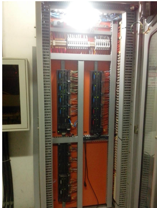
Figura 6 - Painel de automação antigo Fonte: Autoria Própria
