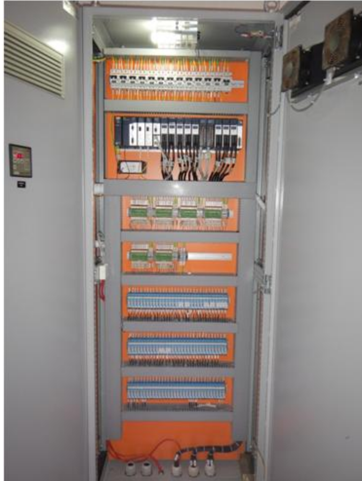
Figura 9 - Novo Painel de Automação Fonte: Autoria Própria
