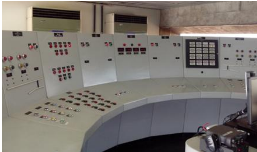
Figura 2 - Mesa de comando da eclusa Fonte: Autoria Própria
