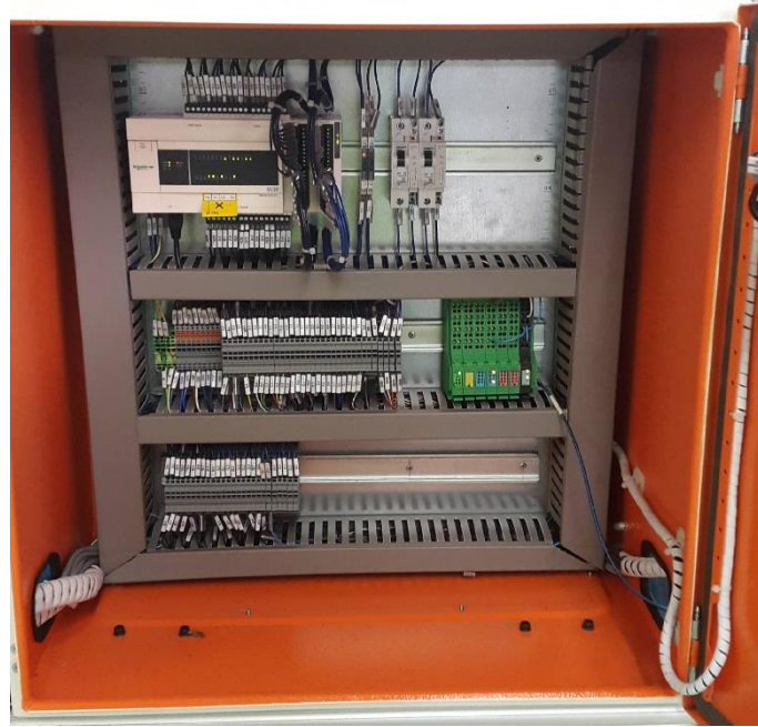
Figura 16 – Painel elétrico e CLP Fonte: Autoria própria
