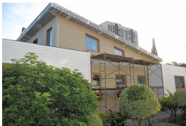
Figura 11 - Construção física do Escritório Verde - Colocação dos materiais ofertados FONTE: Arquivo TECVERDE, 2011.
