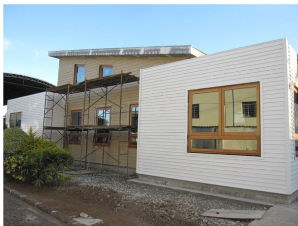
Figura 12 - Construção física do Escritório Verde - Colocação dos materiais ofertados FONTE: Arquivo TECVERDE, 2011.
