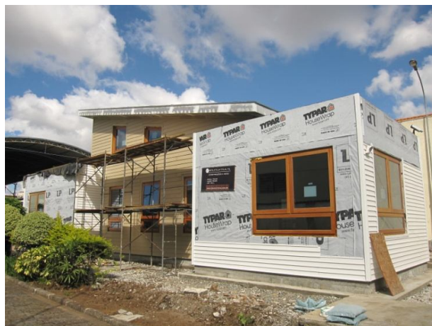
Figura 10 - Construção física do Escritório Verde - Colocação dos materiais ofertados FONTE: Arquivo TECVERDE, 2011.
