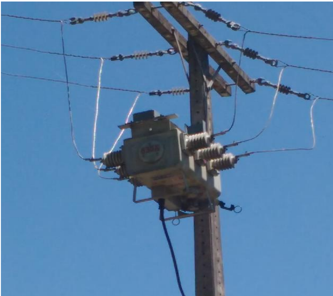
Figura 5- Chave seccionadora gás isolante (SF6).
