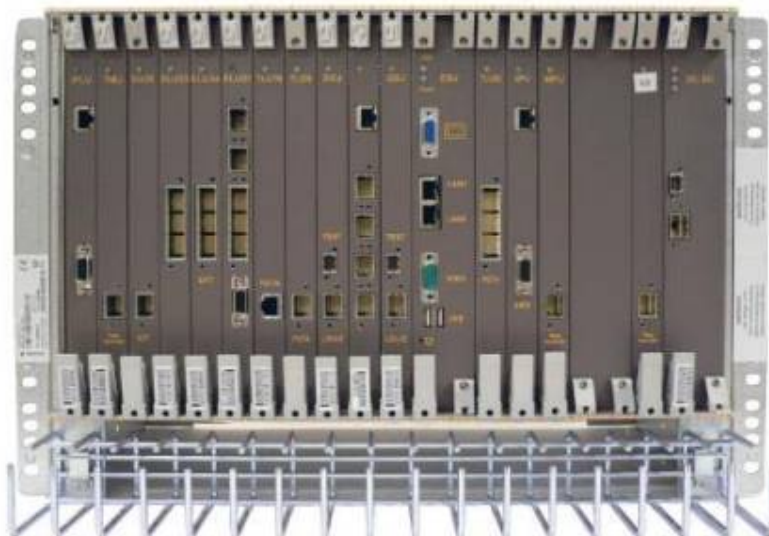
Figura 21: Gabinete LBP22 da MX-One (Fonte: Servidor de Comunicação MX-ONE 5.0 – Administração, 2014).
