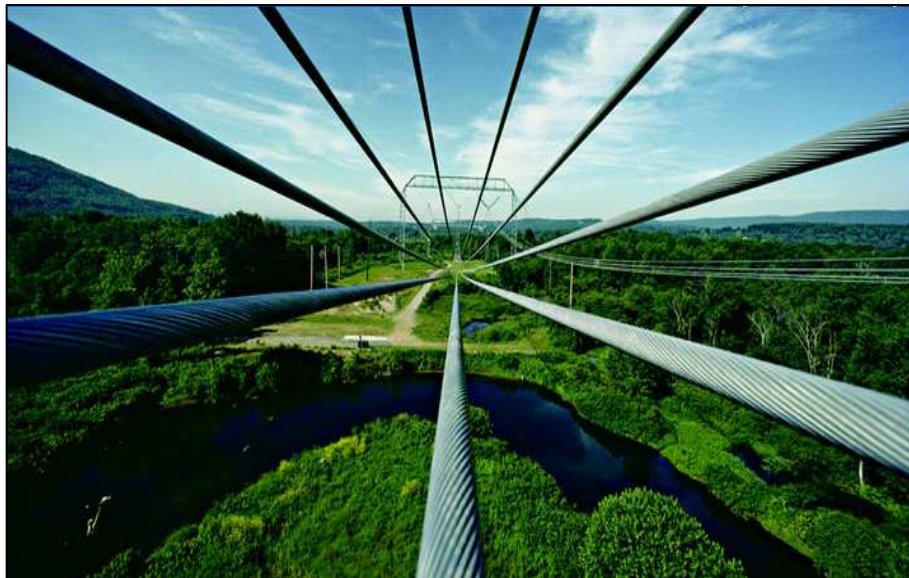
Figura 3- Torre de transmissão que emprega condutores nus de alumínio.
