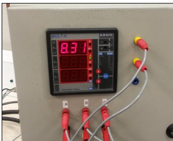
Figura 32 – Multimedidor Fonte: Autoria Própria.
