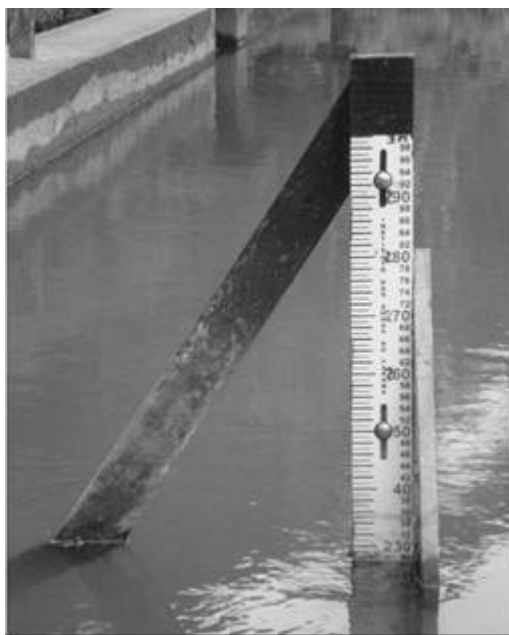
Figura 22 – Linímetro instalado no reservatório Fonte: Própria.
