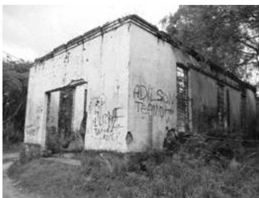
(a) – Casa de máquinas
