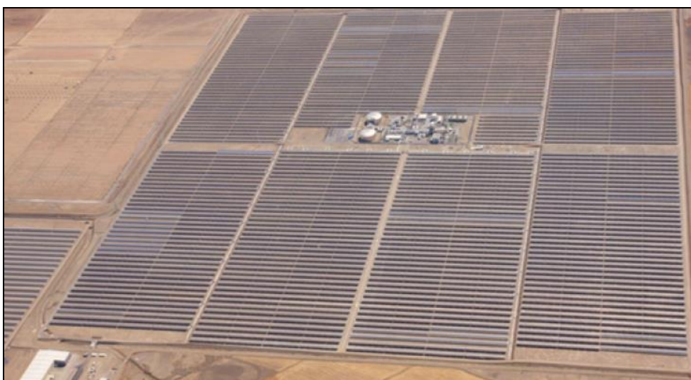
Figura 6: Planta de CSP desenvolvida de calhas parabólicas, na Espanha. Fonte: GIZ, 2014
