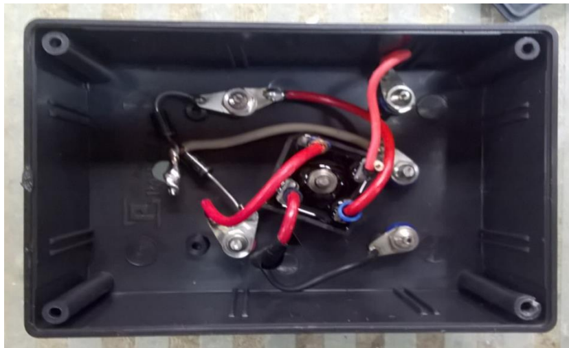
Figura 31 - Detalhes do retificador de onda completa em ponte utilizado. Fonte: Própria.
